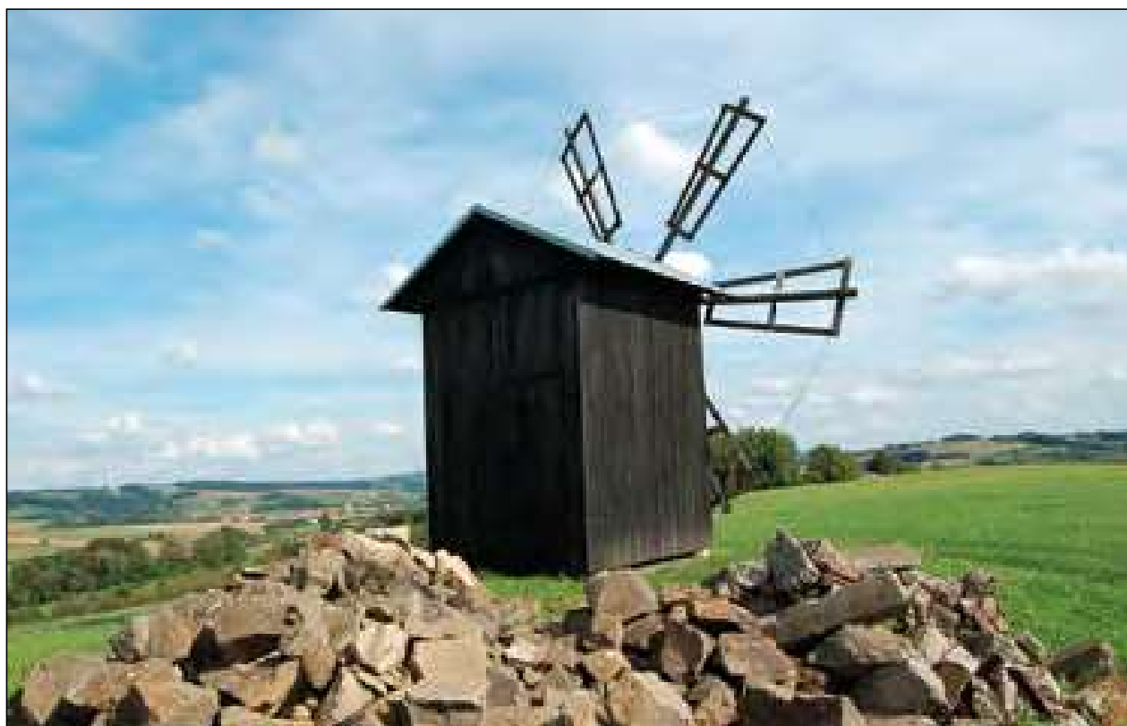
Fot. 2. Wiatrak kozłowy w Różance – stan zachowania po remoncie przeprowadzonym na pocz. XX wieku, widok od strony wejścia. Fot. G.Stojak
